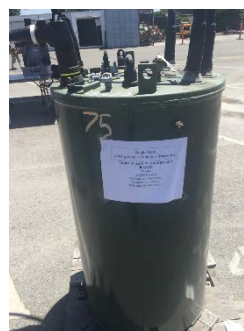
b). 75 kVA transformer
